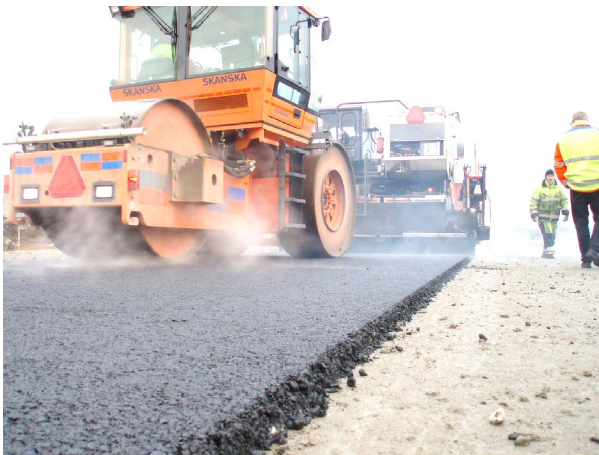
Bild 2-1 Utläggning av 50 mm AG med 40 % förnygrad returafalt i på grusunderlag i Stafsinge industriområde i november 2009.
